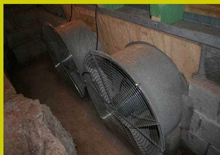
Tolsma kwam met het idee om 2 kleinere ventilatoren te installeren om zo de diepte van de ventilatiekanalen te beperken.
